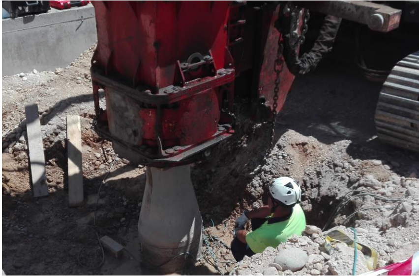
Figura 21. Prueba de carga dinámica sobre pilote in situ con martillo de hincia (RK)
